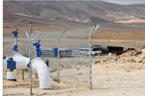
Opresme et provocation / Une station de pompage israélienne toute neuve, parfaitement entretenue et protégée, installée à quelques mètres d'un groupe d'habitations bédouines...
